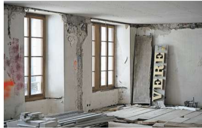
Die Hotels sind aktuell eingerüstet. Ein Blick ins Innere (von oben): Die Paradiesquelle im Ochsen, alte Fenster, die Bäder im Untergeschoss und ein Teil des alten Verenahof-Schriftzugs.
